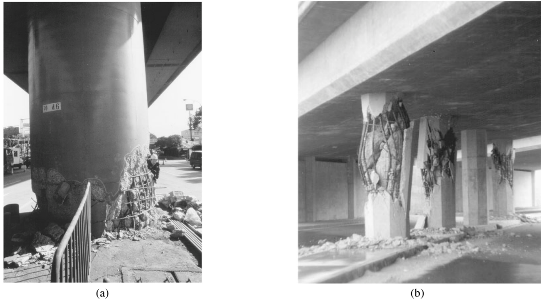
Figura 9.2. Avarierea unei pile de la viaductul Hanshin în timpul cutremurului din 1995 din Kobe, Japonia (a) și cedarea din forță tăietoare la pilele unui viaduct la cutremurul San Fernando, SUA, din 1971 (b), Moehle și Eberhard, 2000.
