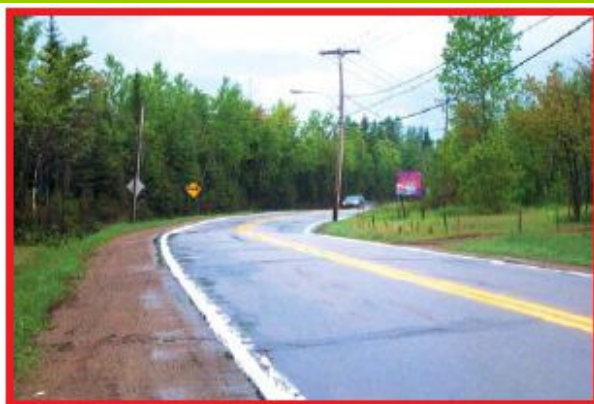
Amplasarea periculoasă a unui stâlp în curbă orizontală.
