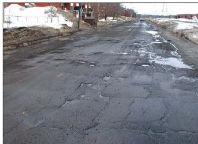
Degradare avansată a suprafeței de rulare (combinație de diferite tipuri de probleme: rupturi, gropi, tasări și burdușiri).
