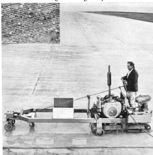
Fig. 53. Striuri transversale realizate pe suprafața betonului.
