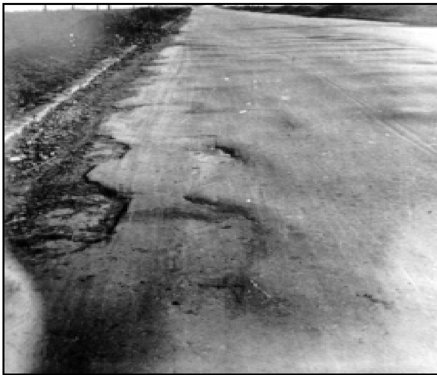
Fig. 2.10. Rupturi de margine cu văluriri și refulări
