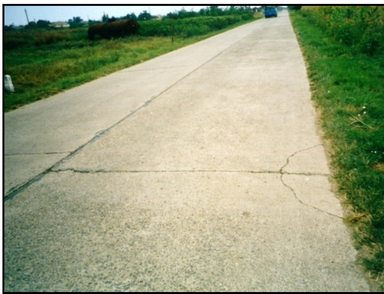
Fig. 3.11. Fisuri de colț
