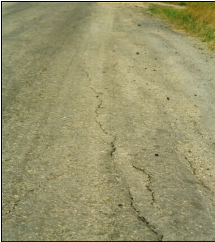
Fig. 2.13. Fisuri longitudinale pe diverse generatoare
