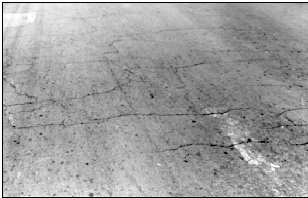
Fig. 2.14. Fisuri multiple pe direcții diferite
