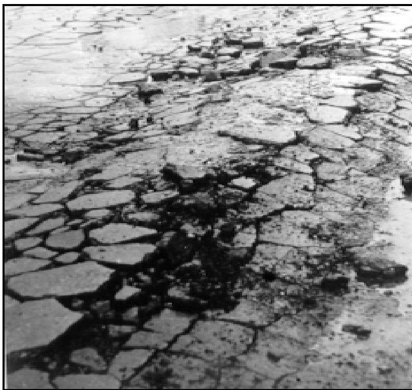
Fig. 2.20. Degradări din îngheț-dezgheț
