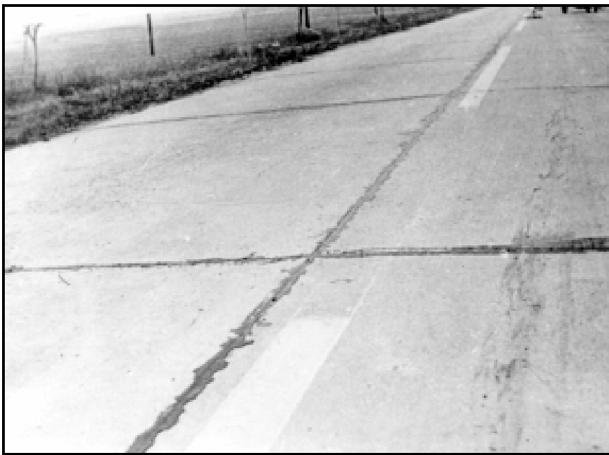
Fig. 3.6. Rosturi cu mastic în exces
