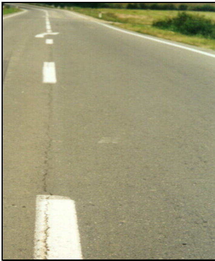
Fig. 2.12. Fisură longitudinală în axa drumului
