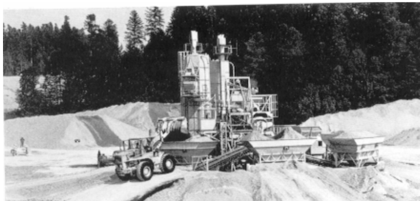
Fig. 3.22. Centrală de mare productivitate pentru prepararea betoanelor.
