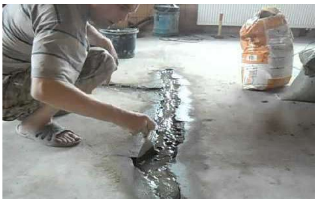
Figura 7. Defecte ale șapei autonivelante.[11]
