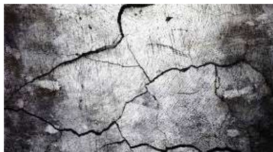
Figura 1. Crăpături și fisuri în beton [7]
