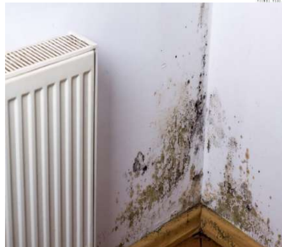
Figura 2. Mucegaiul apărut din cauza igrasiei
