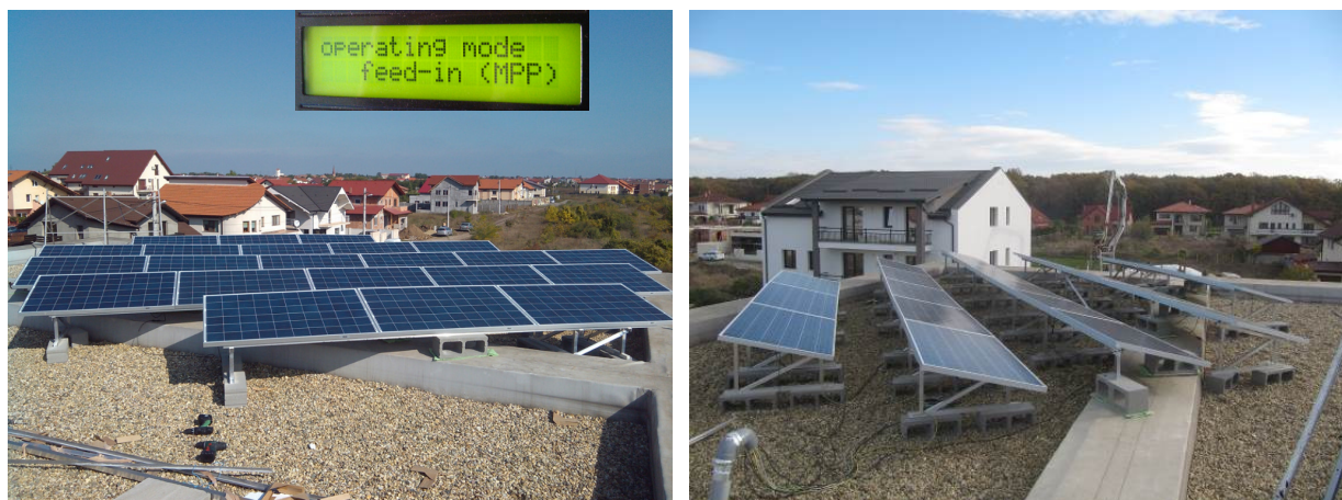
Figura 10 Imagini cu panourile fotovoltaice instalate pe acoperis
