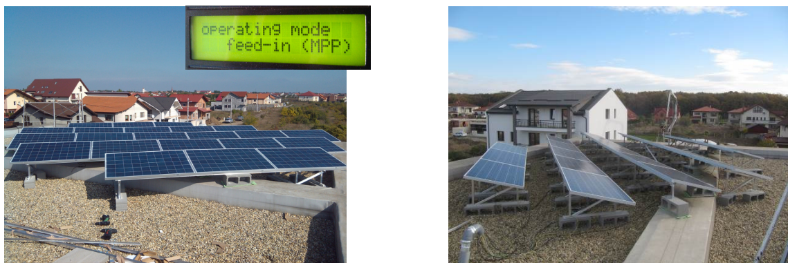
Figura 3.34. 10 Imagini cu panourile fotovoltaice instalate pe acoperis
