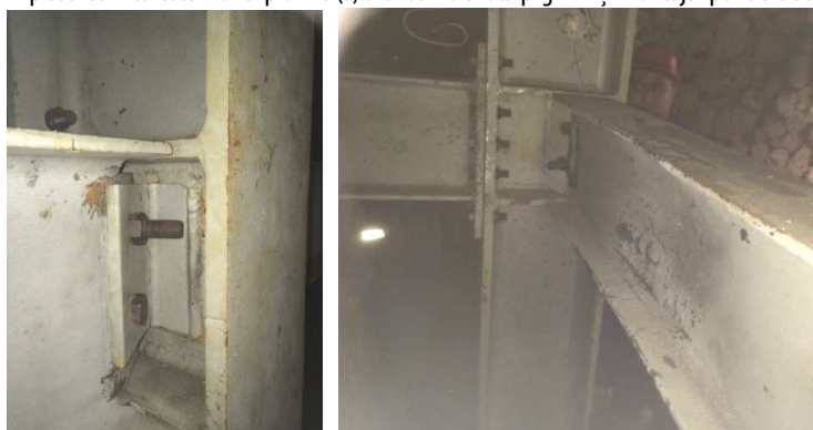
Fig. 17 Deformații pe grindă și în îmbinare grindă-stâlp, încărcătura explozivă de masă m_3=500 g
