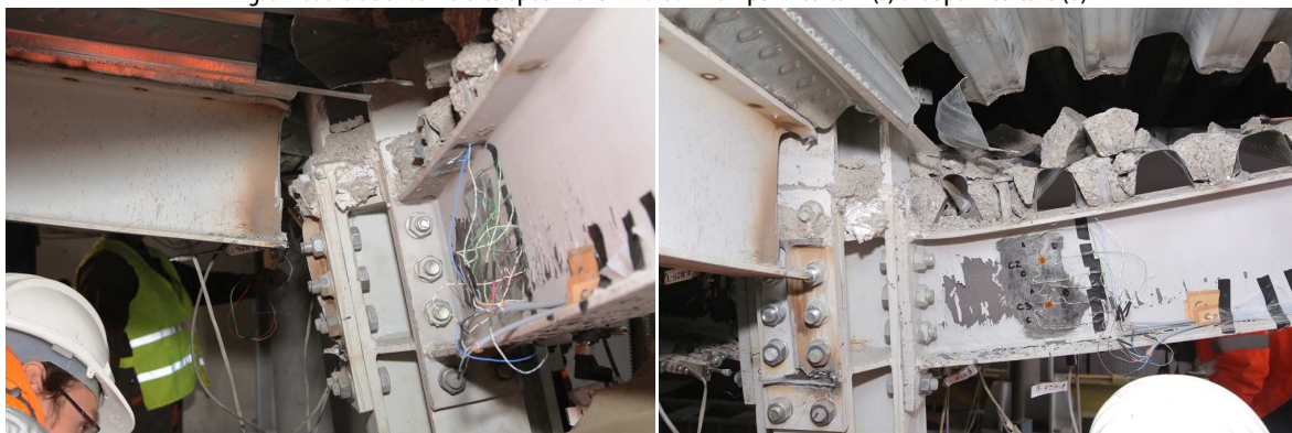
Fig. 10 Cedarea imbinarii grinda-stalp si a placii de beton
