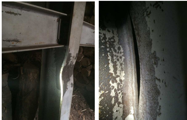
Fig. 18 Deformații în stâlp și ruperea în inimă la racordul cu talpa, încărcătura explozivă de masă m_5=1000 g
