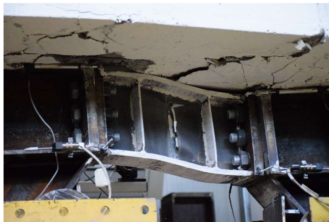
Figura 26. Deformația și cedarea și starea linkului la sfârșitul încercării LF4-C-BR
