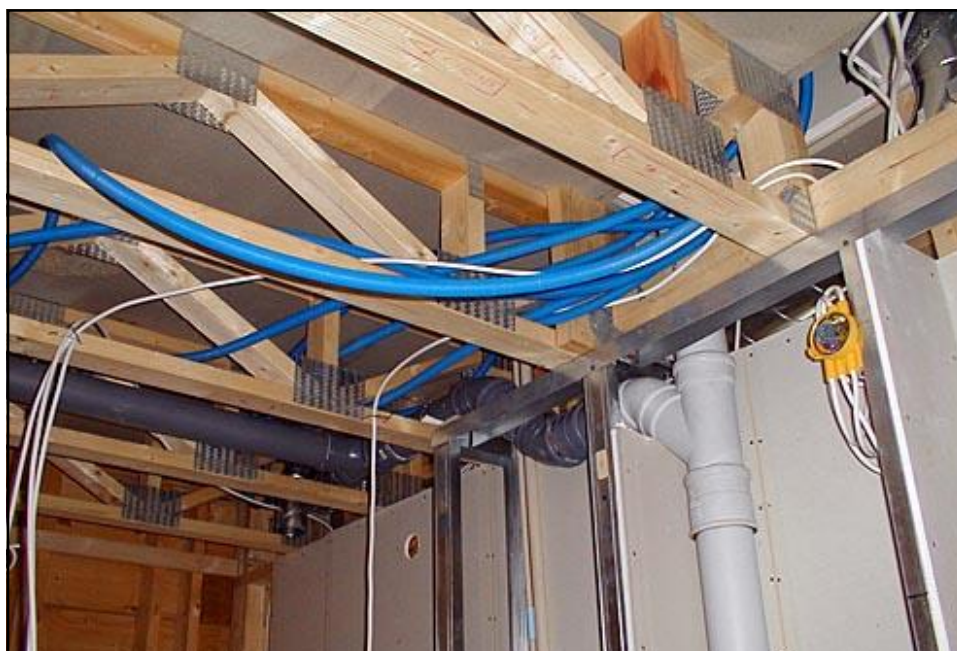
GRINZILE CU ZABRELE DE PLANSEU PERMIT REALIZAREA TUTUROR INSTALATIILOR IN INTERIORUL ACESTORA
